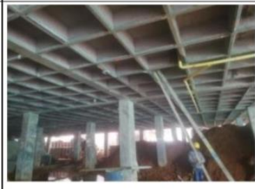
INSTALACIONES SANITARIAS Y ELECTRICAS EN PARQUEADERO
